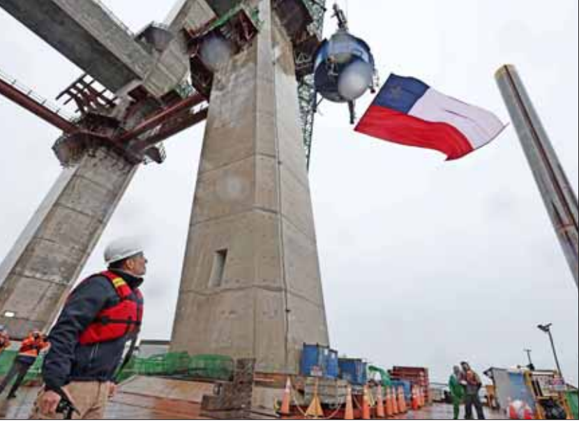
MINISTERIO DE OBRAS PÚBLICAS
